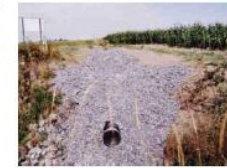
Source: Georges Lamarre (MAPAQ) Déversoir enroché et sortie de drain
