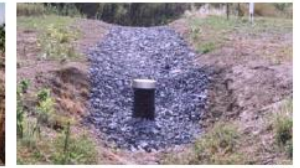
Source: Georges Lamarre (MAPAQ) Avaloir et enrochement du versant amont du déversoir
